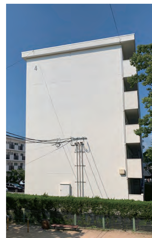
GSF外断熱パネル 結露対策として妻側のみ改修
